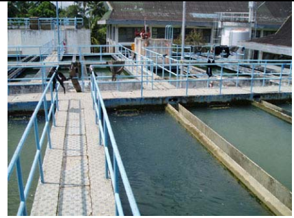
Wasseraufbereitungsanlage in Banda Aceh
