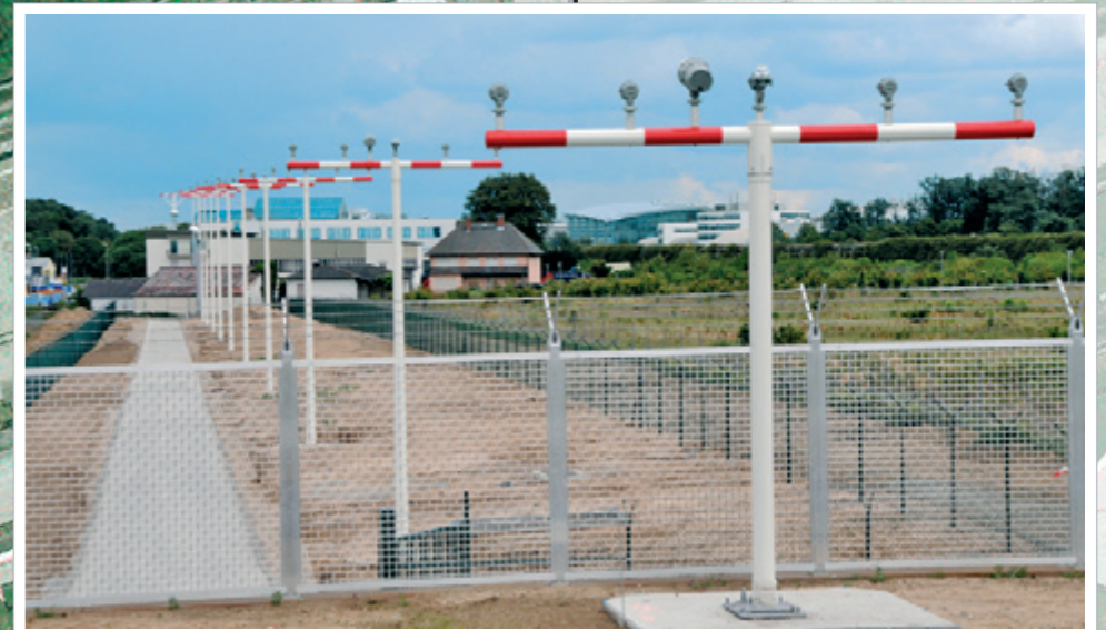
Anflugbefeuerung im Osten (Betriebsrichtung 25).
