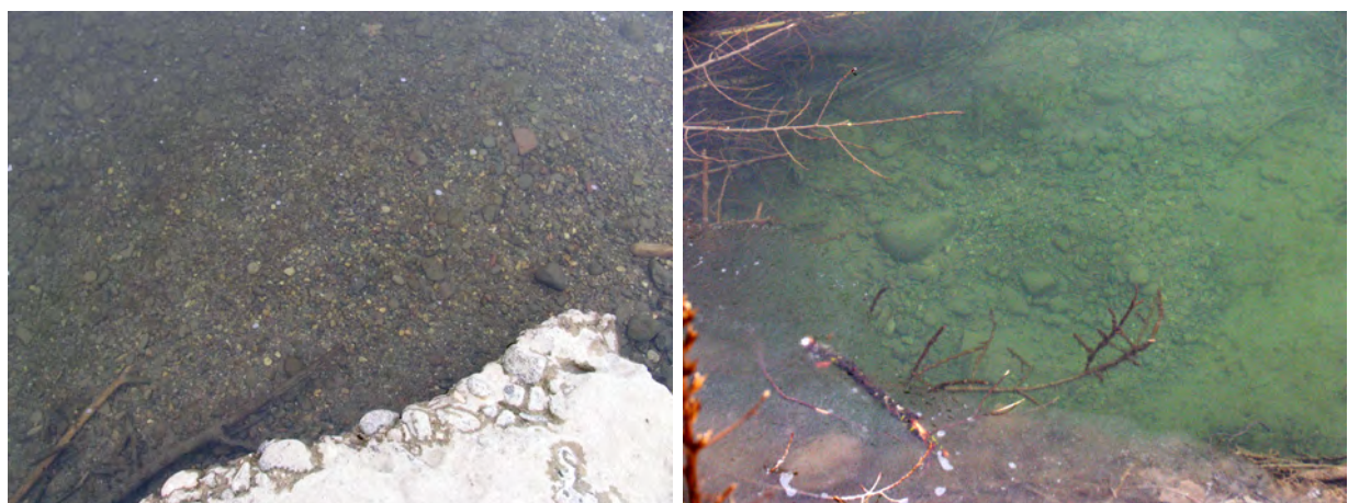
Bild 8.13 Ablagerungen von Schüttmaterial direkt unterhalb (links) und im Kolkbereich der Leitung (rechts).
