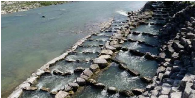
Raugerinne-Beckenfischpass am KW Rheinfelden
